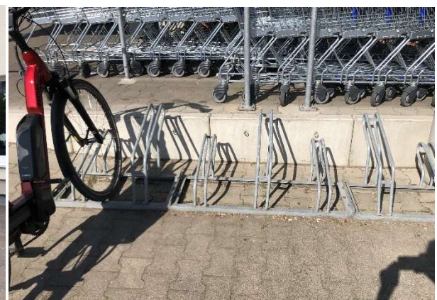
Fahrradabstellanlagen in mangelhafter Qualität (kein sicherer Stand, keine Sicherung gegen Diebstahl, einzeln nicht leicht zugänglich, keine Fläche von mind. 1,5 m 2 pro Fahrrad) (vgl. Maßnahme A39)
