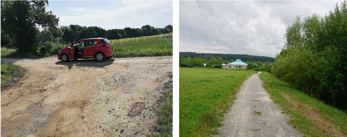
Schäden in der Asphaltschicht (vgl. Maßnahme O5) Unbefestigter Wirtschaftsweg (vgl. Maßnahme O13)
